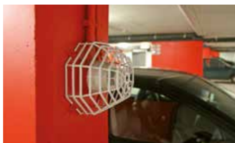
2/3. CO- und Flüssiggassensoren - Bei Überschreiten von frei wählbaren Grenzwerten werden die Systemkomponenten automatisch aktiviert und angesteuert.
